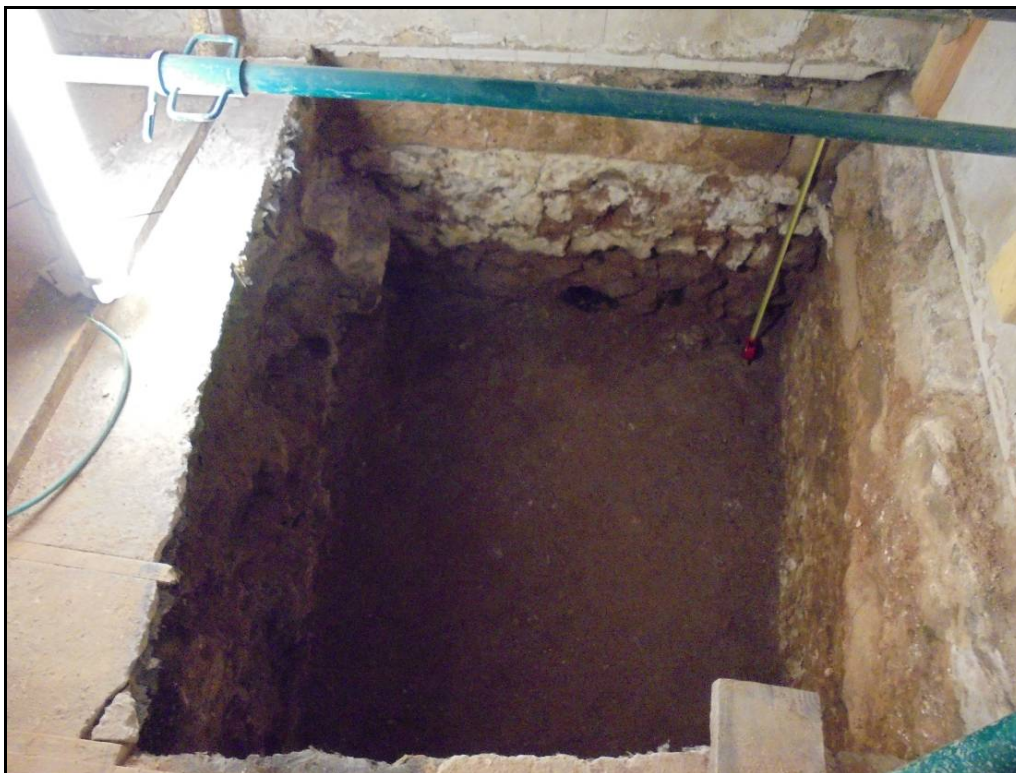
Fotografia 11: Caixa de l'ascensor un cop finalitzats els treballs d'excavació i desmuntatge de les estructures.
